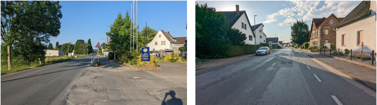
Abbildung 39: Komfortmängel im Radverkehrsnetz: kritischer Belag Basisnetz (links) und Radhauptnetz (rechts)
